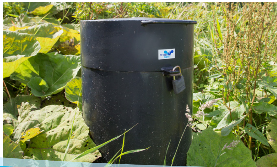
Foto: Monitoringsput voor grondwater, van WMD
