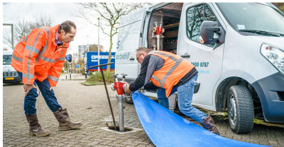
Foto: Om de kwaliteit van het drinkwater hoog te houden, worden leidingen regelmatig schoongespoeld (ook wel 'spuien' genoemd). Water wordt onder hoge snelheid door het leidingnet gestuurd. De in het water voorkomende natuurlijke stoffen zoals mangaan en ijzer stromen zo vanuit de leidingen, via een brandkraan, naar de dichtstbijzijnde waterafvoer.
